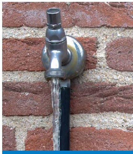
Eingefrorene Rohre. Frieren Leitungen im Winter ein, bekommen Hausbesitzer weniger Geld vom Gebäudeversicherer.
