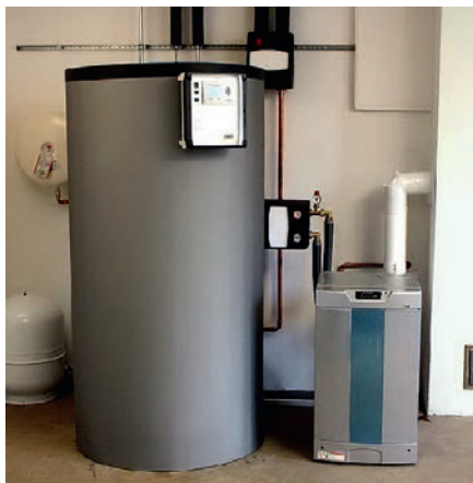
Pufferspeicher. Der Whispergen erhitzt 800 Liter Wasser auf Vorrat.
